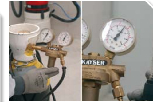
6 Comprobar los contactos y el manorreductor.
