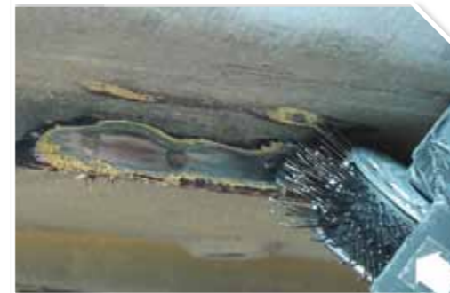
2 Limpiar los selladores, en caso de que sea necesario para la correcta visualización del punto
