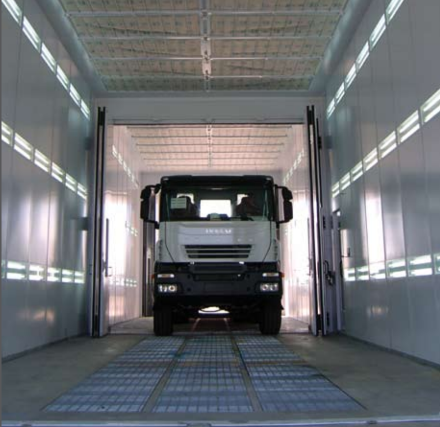
La cabina de pintado está preparada para autobuses, camiones, portavehículos y maquinaria de obras.
